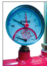
Термоманометр на выходе котла
