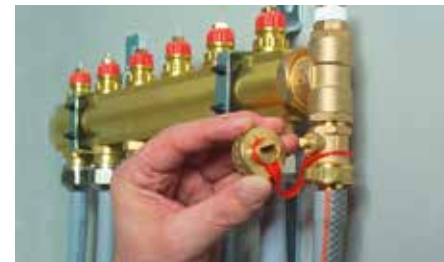
Рис. 3. Подающий и обратный коллекторы оснащены кранами для заполнения и слива теплоносителя.
