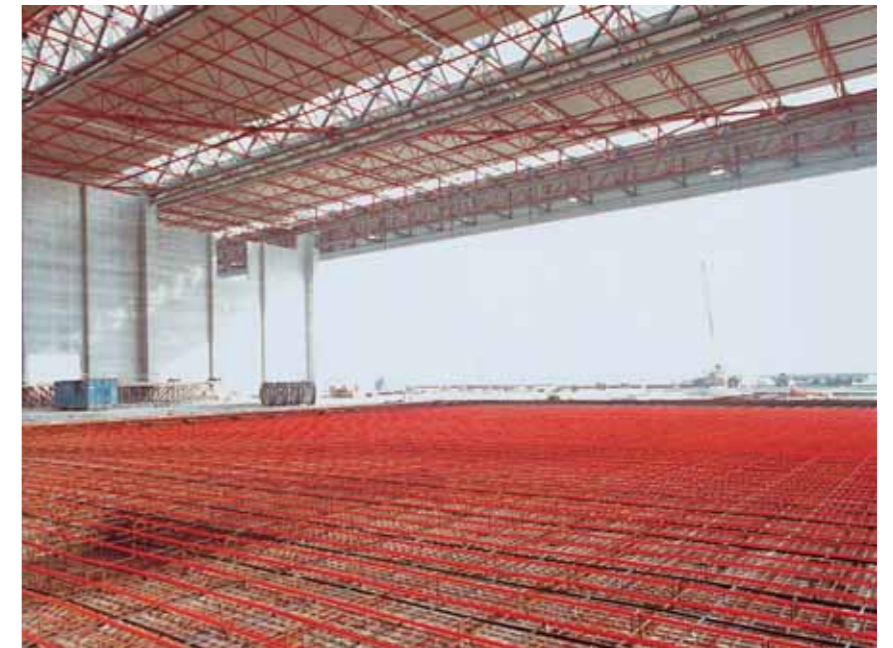
6 Рис. 1: Напольное отопление в новом промышленном цехе
