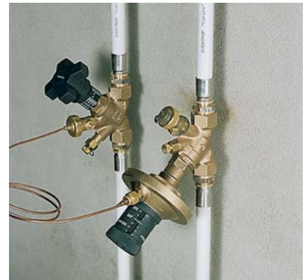
Подключение регулирующей арматуры на стояках
