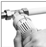
7 Photo 7: Pousser avec la paume de la main la poignée manuelle pour l'enclencher. La plage de réglage du thermostat est ainsi limitée. Le réglage est maintenant limité de 2 à 4 sur la poignée (environ 16 °C à 24 °C).
