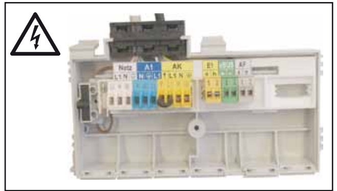
Рис.: Клеммная коробка, Опасность поражения электрическим током
