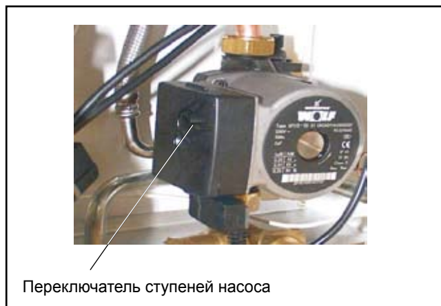
Рис: Переключатель ступеней на насосе котлового контура
