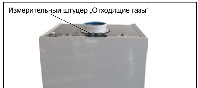
Рис.: Измерение отходящих газов на закрытом котле
