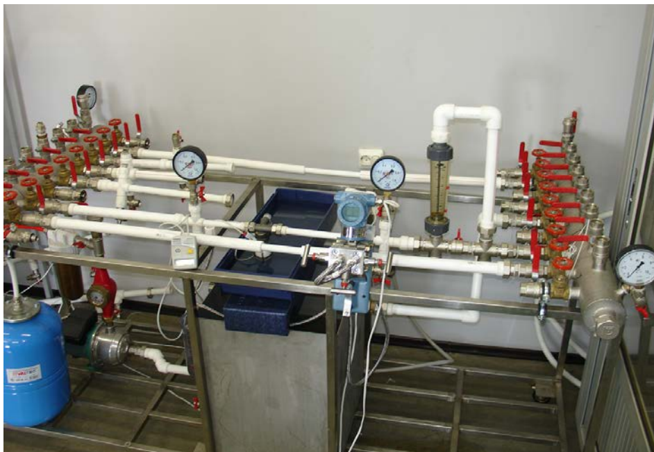
Рис.2.4.3.р.8 Стенд гидравлических испытаний
