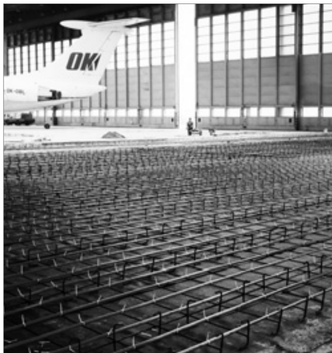
Напольное отопление для промышленных зданий
