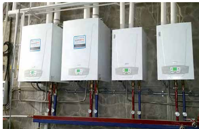
Жилой дом, г. Ставрополь Общая мощность котельной — 300 кВт
