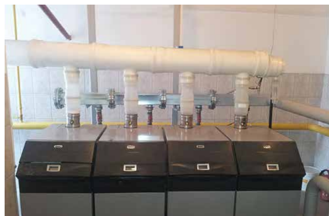
РЦ «Б-45», г. Калуга Общая мощность котельной — 400 кВт
