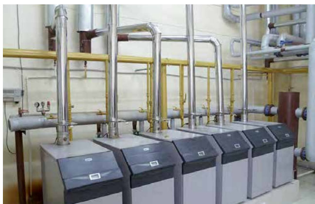
Автосалон Renault, г. Йошкар-Ола Общая мощность котельной — 600 кВт
